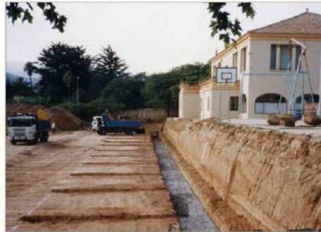
Preparació del terreny per a l'ampliació de l'escola amb la construcció d'un nou edifici. Setembre 1995.
